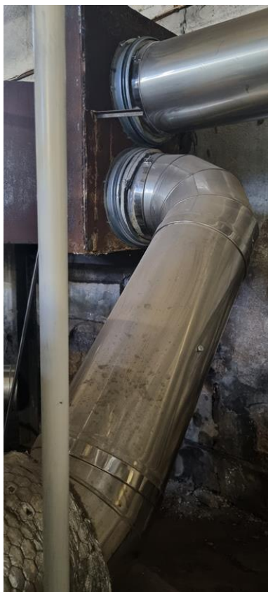
Joonis 2.5 Osaliselt isoleerimata suitsukäigud katlamajas (vasakul)
