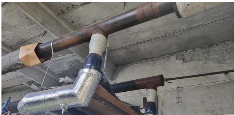
Joonis 2.6 Osaliselt isoleerimata küttevee torustik
